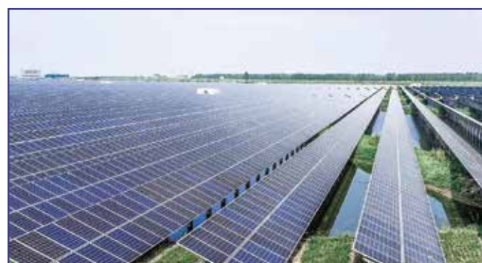
200MW Zhaoan Sidu, Fujian
